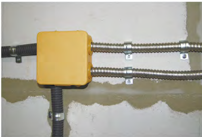
Прокладка кабеля в металлорукаве, разводка кабеля в распаячной огнестойкой коробке (вариант исполнения)
