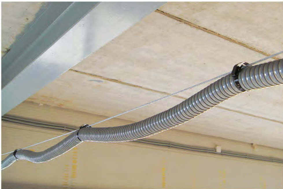
Вариант прокладки кабеля в металлорукаве, закрепленного стяжками бугельного типа СКБ-П (316) FortisFlex на стальном тросе
