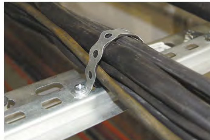
Вариант крепления пучка кабелей в лестничном лотке с помощью перфорированной монтажной ленты
