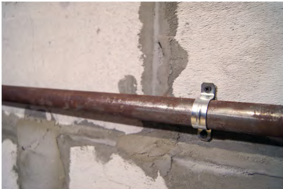
Вариант прокладки кабеля в трубе стальной электросварной при помощи скоб двухлапковых (вариант исполнения)
