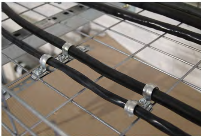
Крепление кабеля в металлическом проволочном лотке с помощью скоб однолапковых (вариант исполнения)
