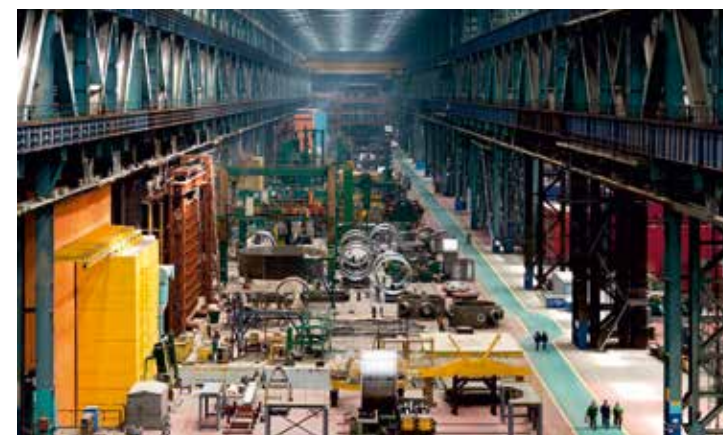
завод «Атоммаш», г. Волгодонск Установленные системы: ПС, ППТ.
